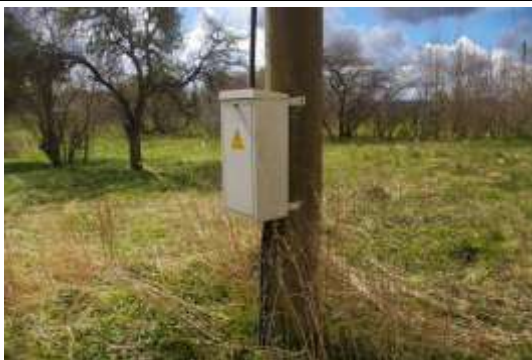
1.zemes vienība ar kadastra apzīmējumu 6498 001 0158, elektrosadalne un uzskate
